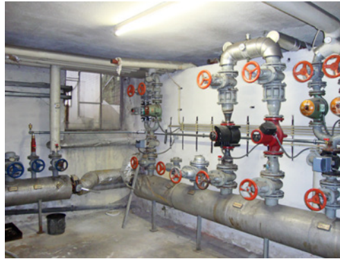
Die Heizungssteuerung für das Schulzentrum ist veraltet, eine Erneuerung ist dringend notwendig
