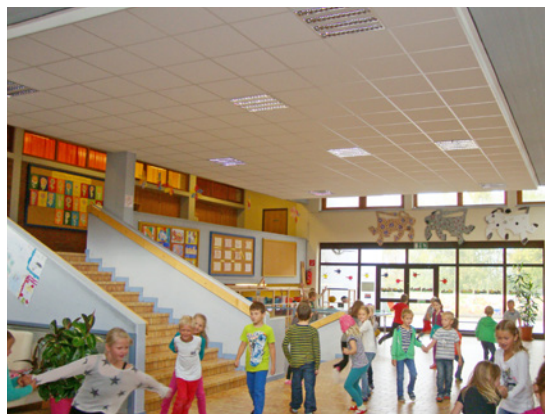
Die neue Akustikdecke soll den Lärmpegel in der Aula der Volksschule verringern. In diesem Zug wurde auch eine LED-Beleuchtung angebracht
