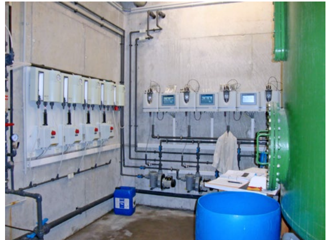
Die neue Chlorungsanlage des Freibades befindet sich unter der großen Flächenrutsche
