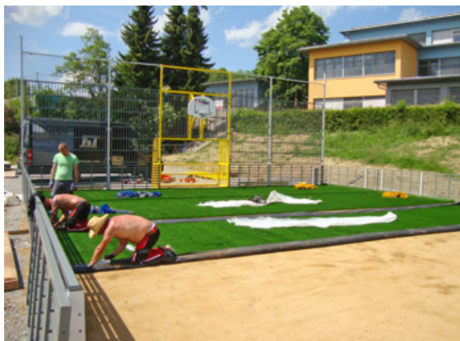
Die Mitarbeiter der Firma Sportbau HL bei der Verlegung des Kunstrasens. Voraussetzung dafür war ein planer Untergrund, der vom Gemeindebauhof errichtet wurde
