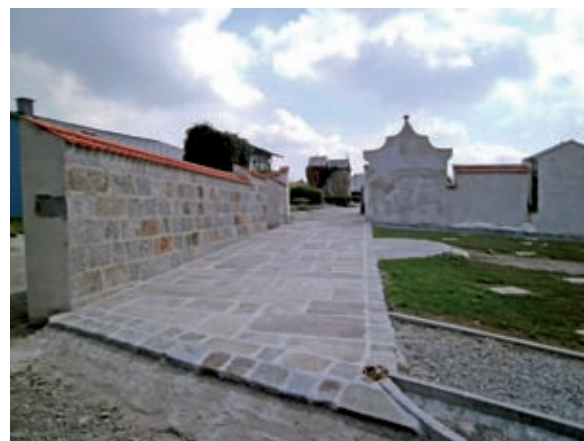
Die gepflasterte Zufahrt mit der neu errichteten Steinmauer im oberen Bereich des Friedhofs
