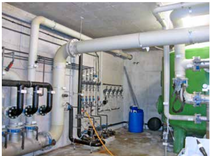
Viel Technik ist für den Betrieb des Freibades notwendig. Diese verbirgt sich in einem großen Raum unter der Flächenrutsche.
