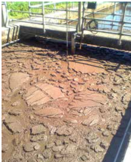
Fettablagerungen im Belebungsbecken der Kläranlage
