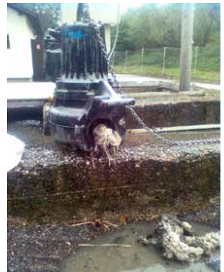
Die Entleerungspumpe im Regenbecken – verstopft mit Feuchttüchern
