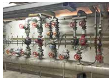
Die Heizverteilerzentrale in der Volksschule vor ...
