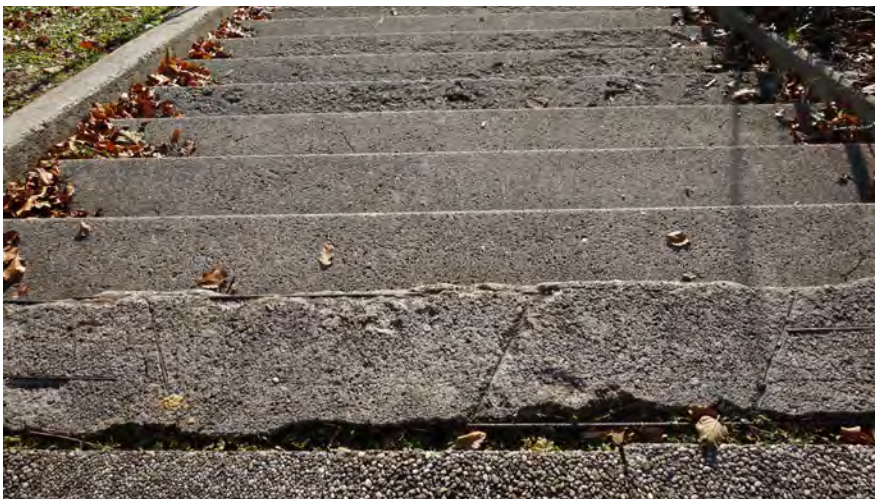
Der desolate Stiegenabgang zum Funcourt soll ebenfalls saniert werden
